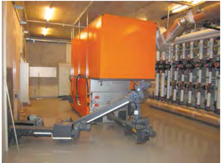
Chaudière à pellets de l'école Marcelly
