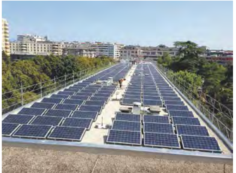
Panneaux photovoltaïques sur les immeubles locatifs communaux avenue Adrien-Jeandin
